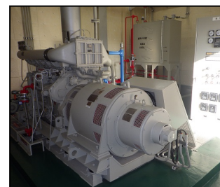
非常用自家発電設備 (全ての配水場72時間稼働可能)
