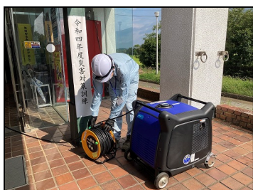
災害対策訓練 (庁舎の非常用電源設置)
