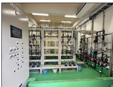
⑩次亜塩素酸ナトリウム注入室
