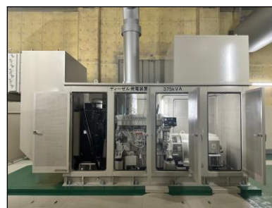
⑪非常用自家発電設備 (全ての配水場で72時間稼働可能)
