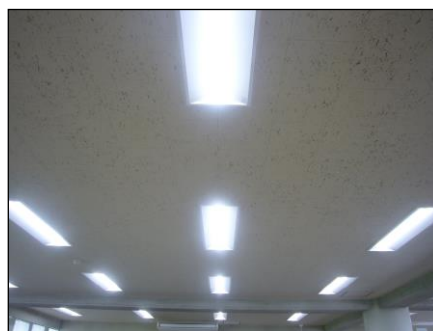
㉒事務局庁舎のLED照明
