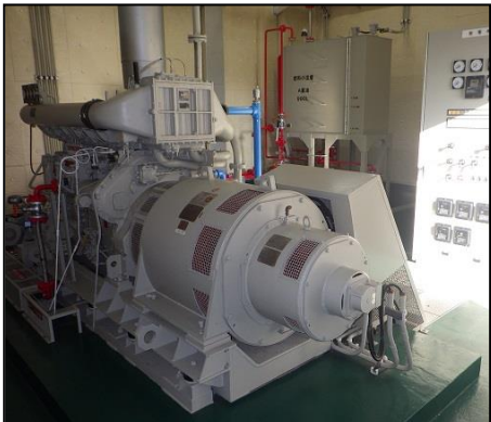
非常用自家発電設備（東金配水場）
