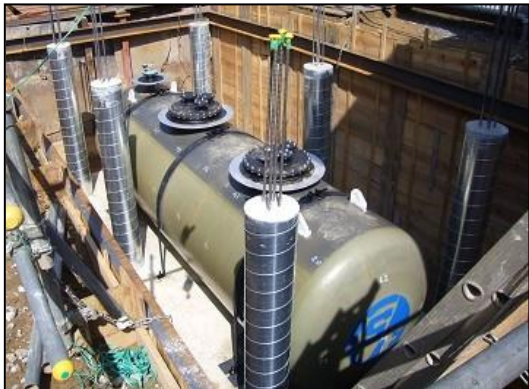
地下燃料タンク（東金配水場）
