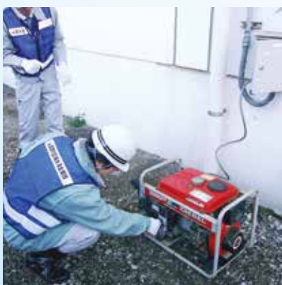
②非常用発電機始動訓練
