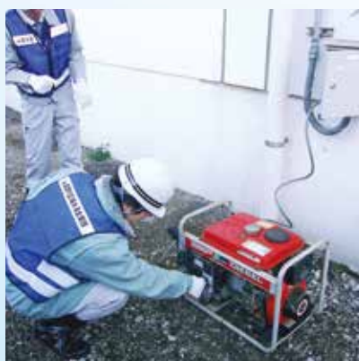
②非常用発電機始動訓練
