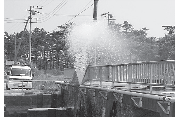
平成27年5月 漏水事故（水管橋）
