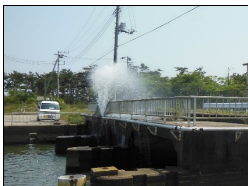
漏水状況（水管橋）
