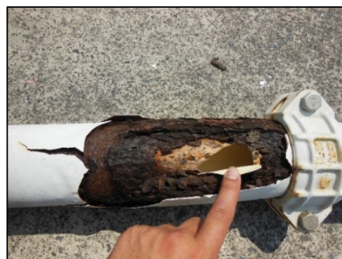
漏水箇所の拡大図（配水管腐食）
