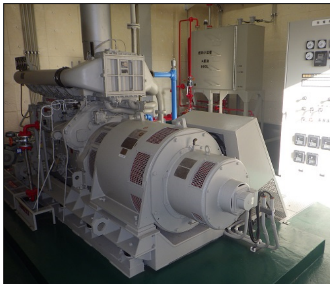
非常用自家発電設備（東金配水場）
